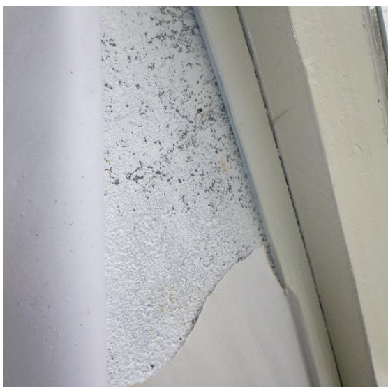
Wanden zijn niet strak afgewerkt.
