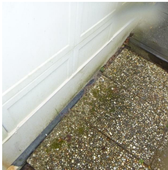
Niet duidelijk waarvoor onderzijde wanden berging bekleed zijn met respect.
