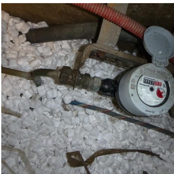
Mogelijk hele lichte lekkage te plaatsen aansluiting watermeter.
