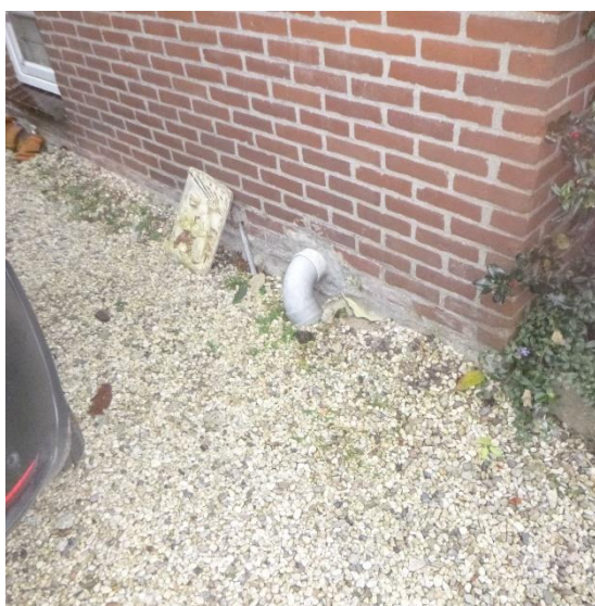
Riool komt kwetsbaar uit de gevel.
