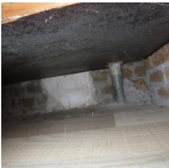
Riool van badkamer loopt door schoorsteenkanaal.
