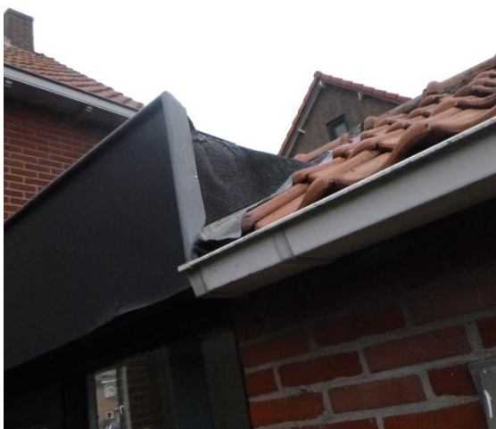
Dakbedekking rommelig aangebracht.
